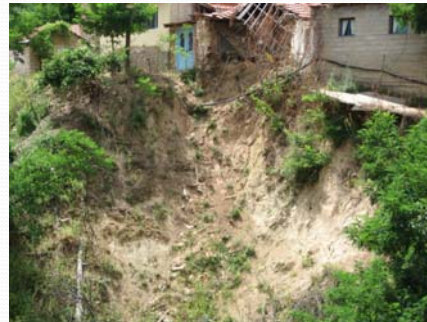
Αστοχία σε αρενιτοποιημένο γρανίτη, Άλωνα Φλώρινας.
